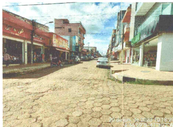
FOTO 4: AUSÊNCIA DE ACESSIBILIDADE E FAIXA DE PEDESTRES
