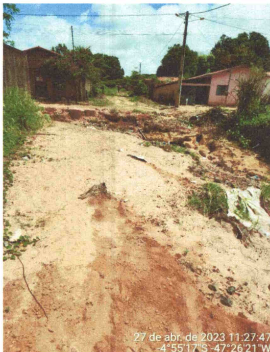
Via pública destruída pelas chuvas
