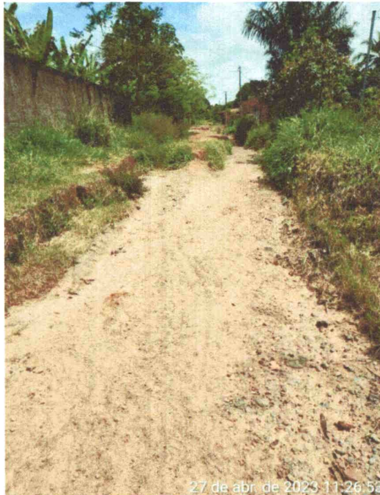
Via pública destruída pelas chuvas
