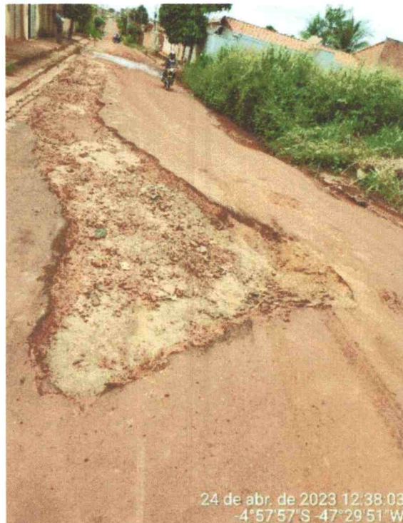
Via pública destruída pelas chuvas
