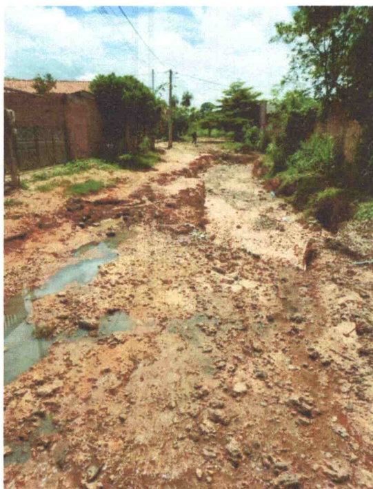
Via pública destruída pelas chuvas
