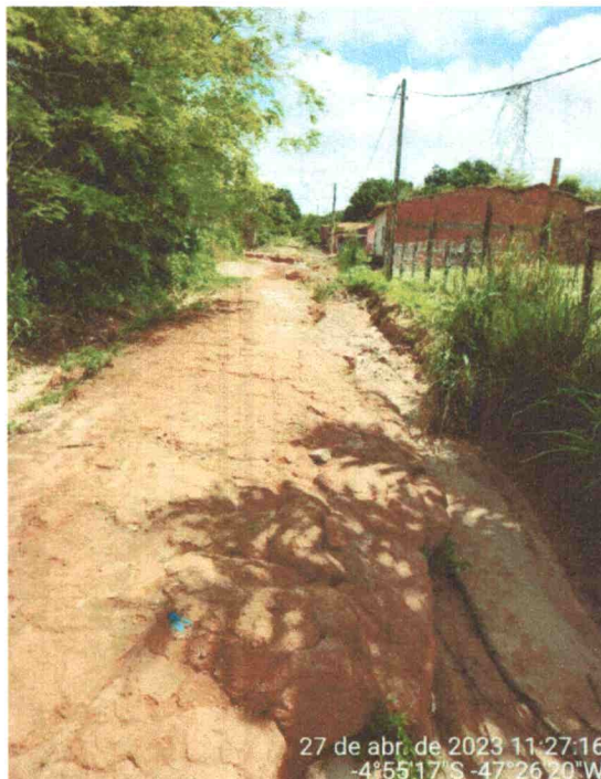
Via pública destruída pelas chuvas
