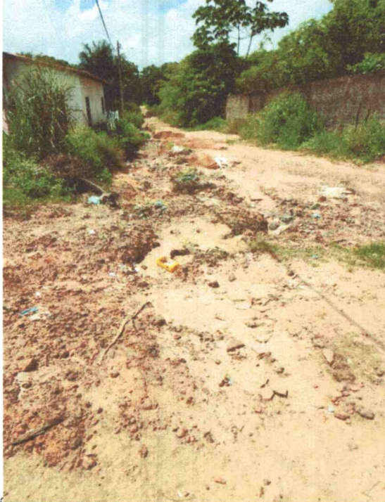
Via pública destruída pelas chuvas
