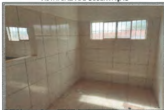
VISTA: SALA DE UTILIDADES
