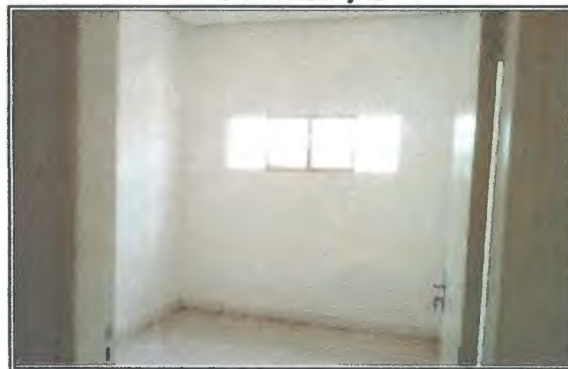
VISTA: SALA DE NEBULIZAÇÃO
