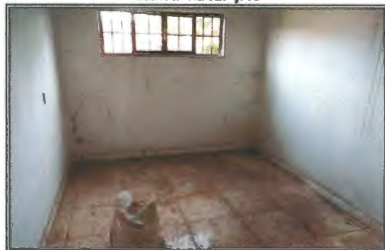
VISTA: SALA DE NEBULIZAÇÃO
