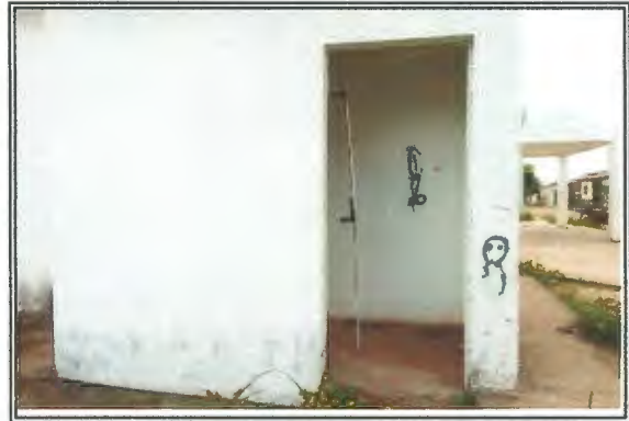
VISTA: SALA DE COMPRESSORES
