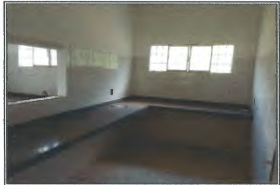
VISTA: SALA DE UTILIDADES
