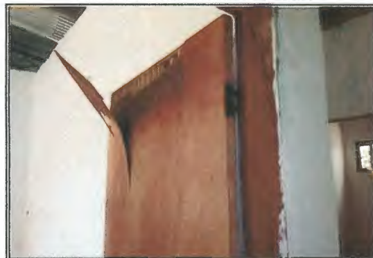
VISTA: ESQUADRIA DANIFICADA 2
