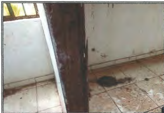
VISTA: ESQUADRIA DANIFICADA 1
