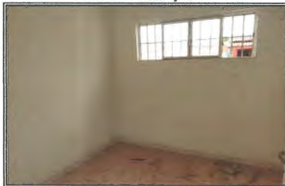
VISTA: SALA DE NEBULIZAÇÃO
