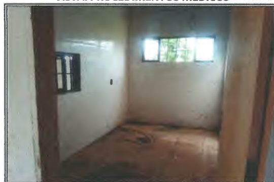
VISTA: SALA DE UTILIDADES
