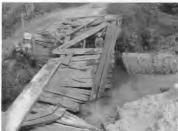
Vista do tabuleiro da ponte de madeira existente com estrutura perdida
