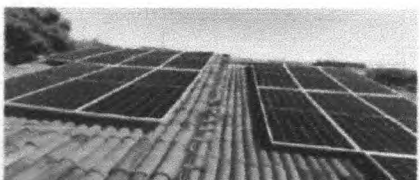
Sistema Solar Fotovoltaico Comercial 9,68 kWp 22 Módulos de 440 W
