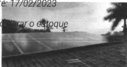
Sistema Solar Fotovoltaico residencial 5,74 kWp 14 Módulos de 410 W
